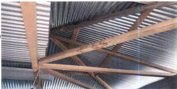
Foto 11: Estructura portante en mal estado.
