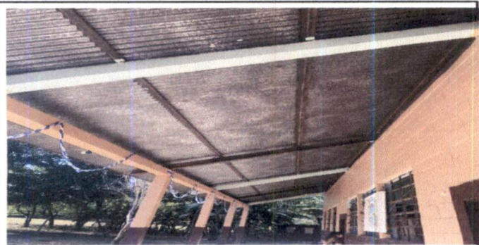
Foto 7: Láminas en mal estado por corrosión.
