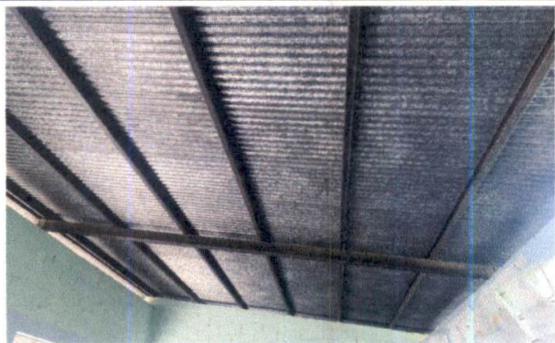
Foto 9: Estructura de metal portante en mal estado por corrosión.
