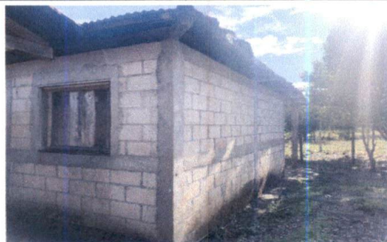
Foto 3: Láminas en pésimo estado.
